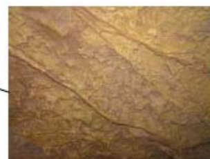
Figures de corrosion
